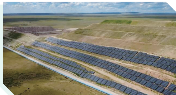
博雷頓建設的光伏發電系統
