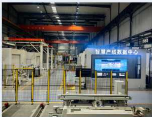
机械制造厂智慧产线数据中心
