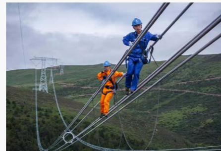
• G.654.E光纖護航特高壓骨幹通道 10
