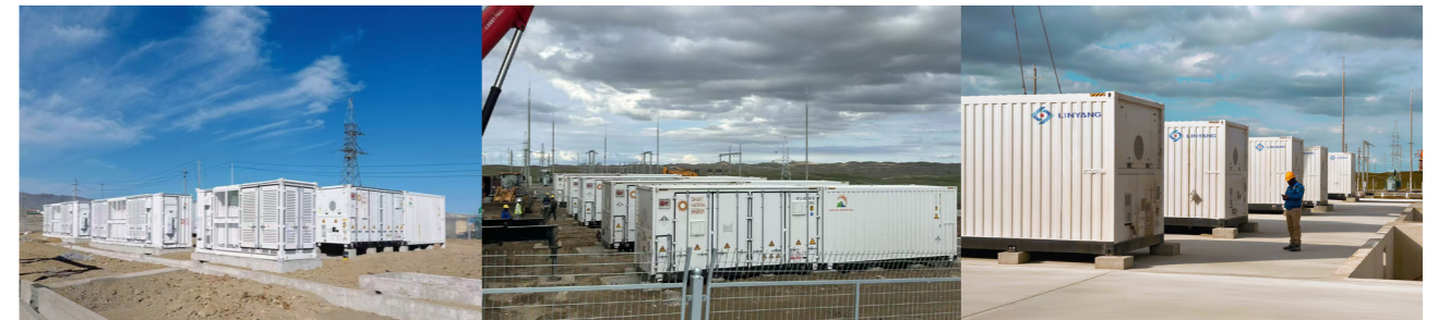
蒙古国 50MWh 储能项目
