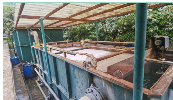
废水处理设施
