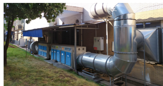
废气处理设施
