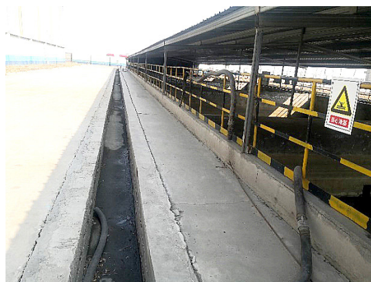
Rainwater collection and utilisation facilities 雨水收集利用設施
