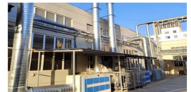
有机废气处理设施
