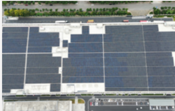
▲ 自建光伏项目
