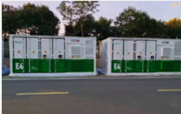
▲ 龙山二基地电力储能设施
