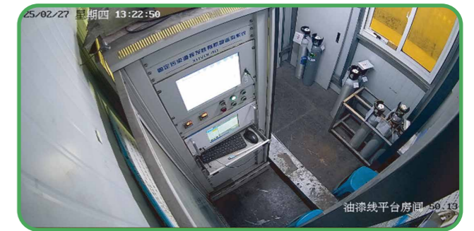
监测系统现场图片
