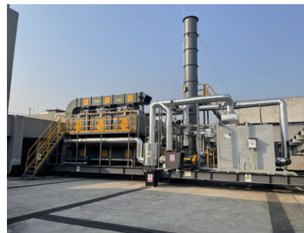
废气处理设施
