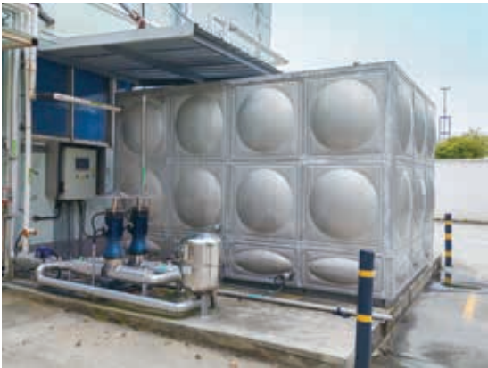
“余热回收”设施
