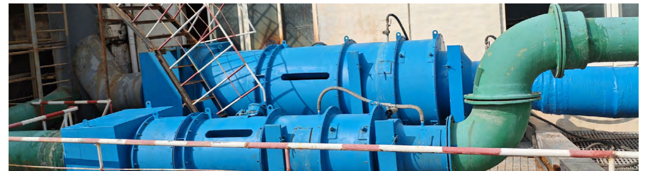
新城金礦破碎除塵系統
