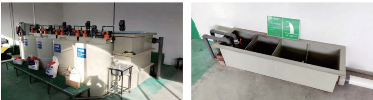
公司废水处理系统
