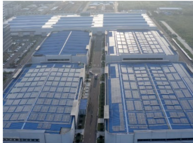
江苏基地光伏设备
