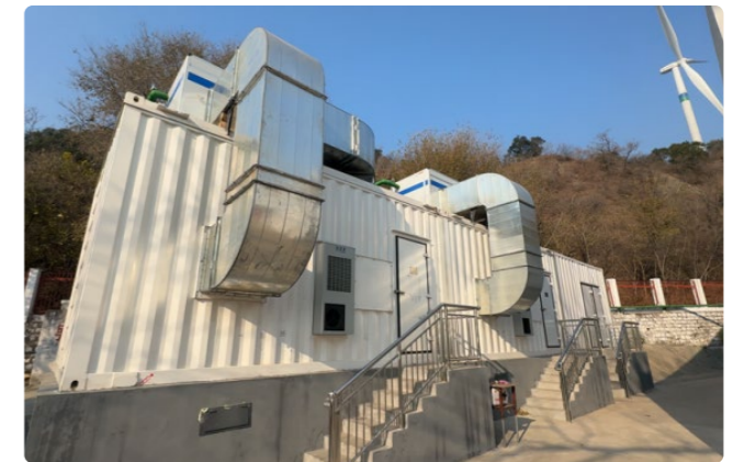
瓦斯抽放泵站
