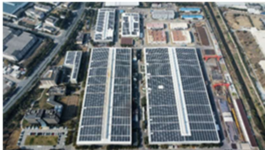
光伏安裝後全景圖
