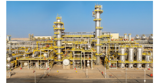
Block 9中央處理設施 (CPF)
