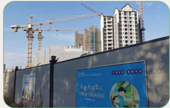
工地降塵噴淋設施
