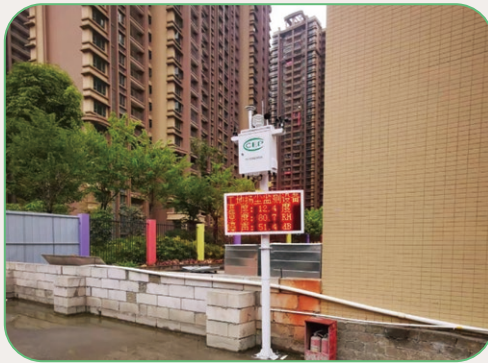
揚塵監測設備
