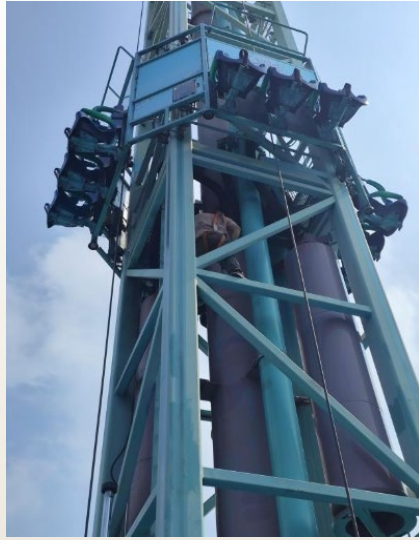
美國S&S遊樂設備廠家工程師現場對項目工程設備人員進行技術指導、培訓
