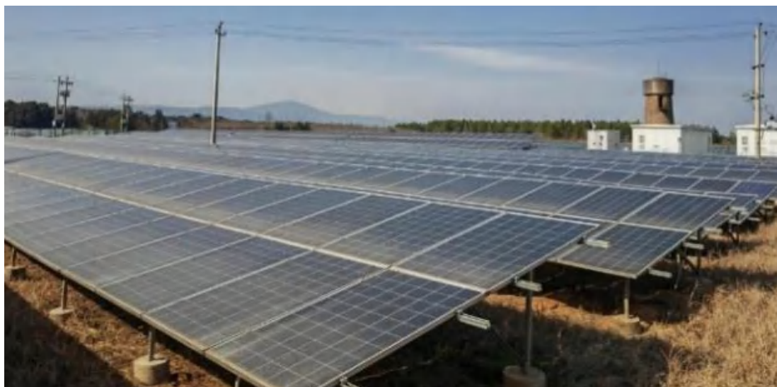
鄉村光伏電站
