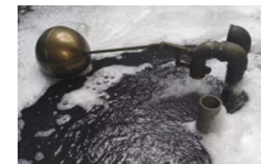
浮球式液位計實現自動化補水
