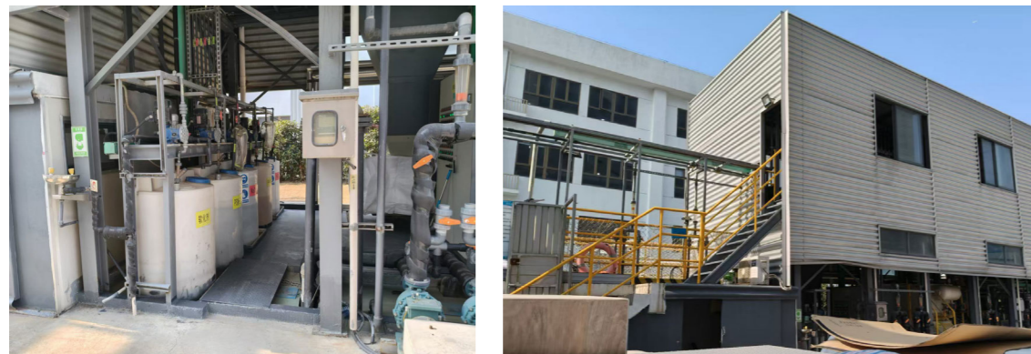
長風藥業污水處理站
