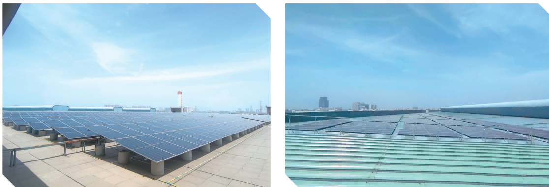
圖註：精密製造公司自建光伏電站
