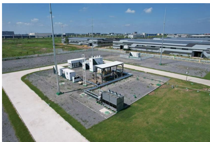
图：盐城大丰光储氢离网制氢项目
