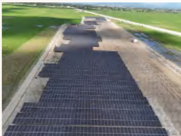
菲律宾8.625MW项目现场图
