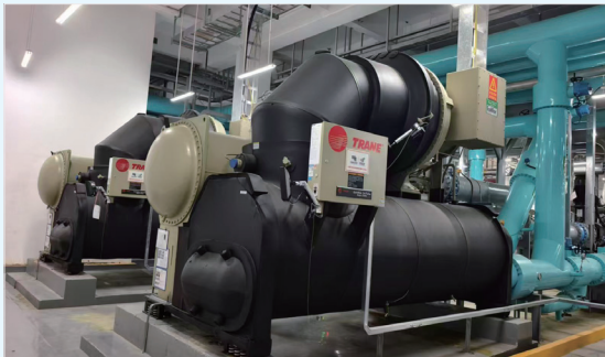
▲ 德赛矽镨中央空调及水蓄冷项目
