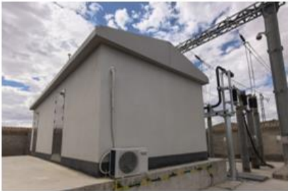
电气化装配式所
