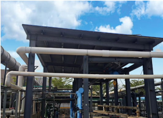
废水治理设施升级
