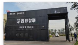
商用车单通道换电站
