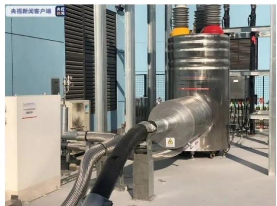
图23: 上海高温超导电缆示范工程成功投运
