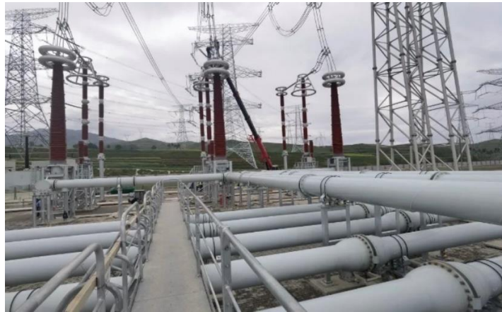
图42：平高电气新一代 800 千伏 GIS 产品成功投运
