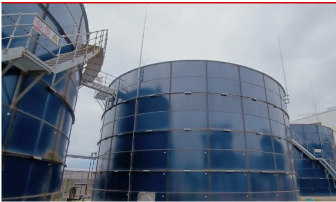
图 14 京基智农高州项目污水处理站
