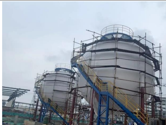
图22：榆林华秦氢能项目 400m 3 氢气球罐
