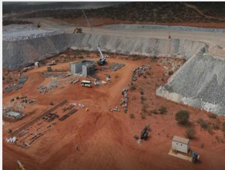
图48：带初级破碎机的原矿平台
