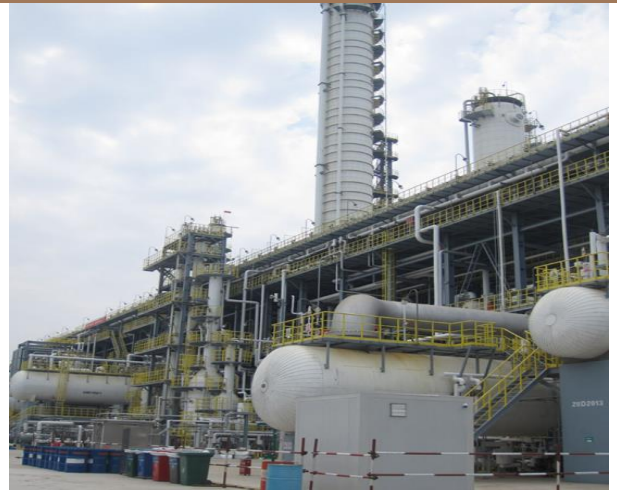
图 15: 烟台万华 PO/AE 一体化项目 LPG 精制及丁烷异构装置
