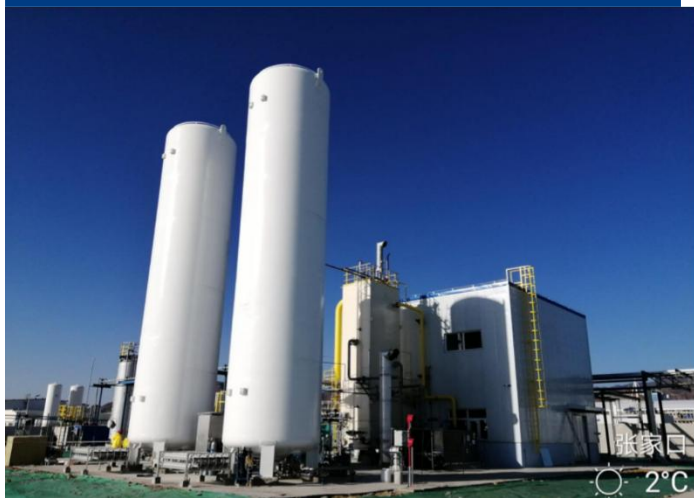
公司氢气液化装置
