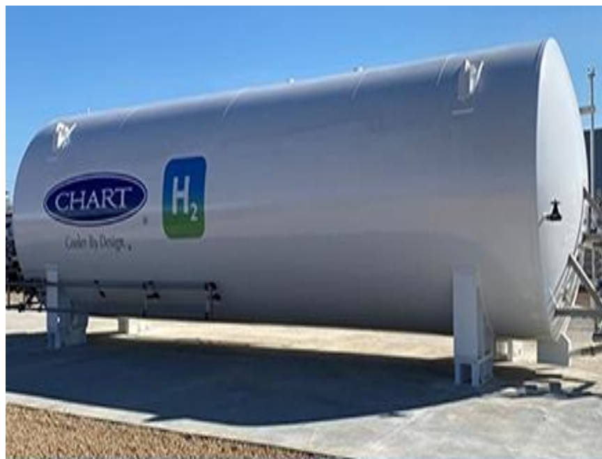
卧式液氢储罐
