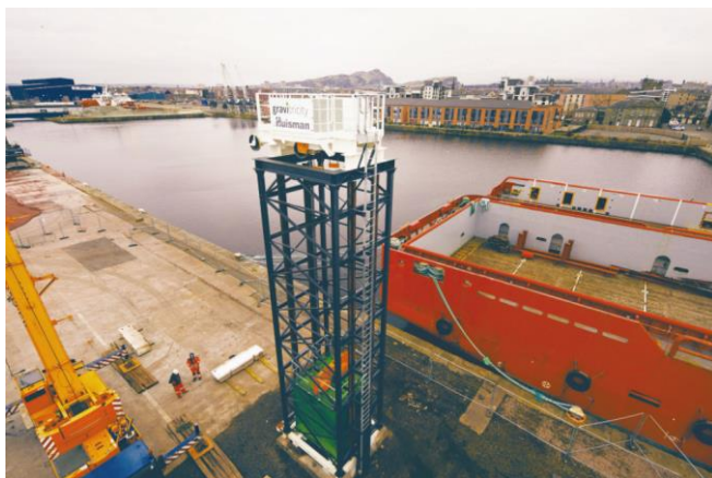
图36 Gravitricity 公司的 250 kW 重力储能示范项目
