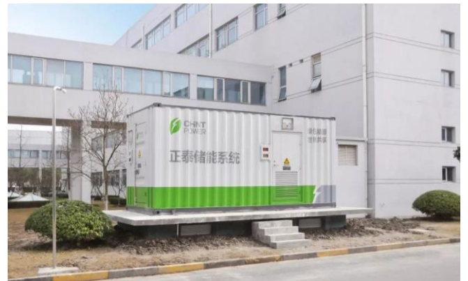
图50 上海新华科技智慧储能项目
