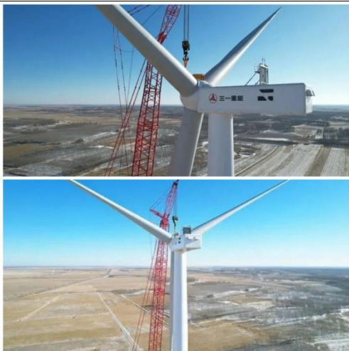
图 26: 三一重能 7.XMW 平台首台风电机组项目
