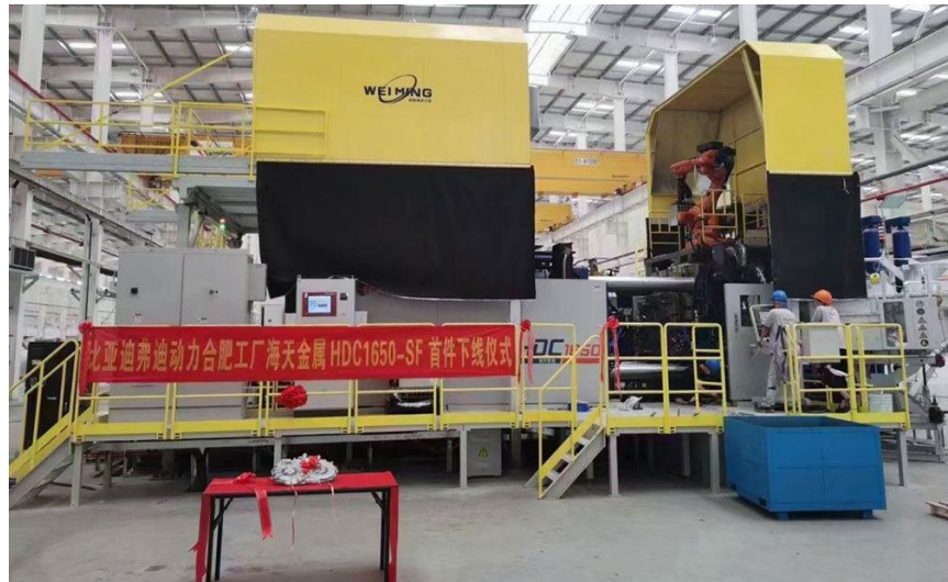
图36：海天金属压铸设备已在比亚迪工厂完成产品下线
