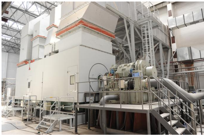
图24：30MW级燃驱压缩机组
