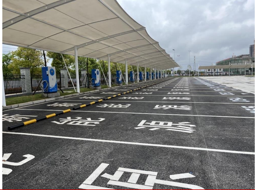
图 19 科林电气武汉大型公交充电站项目
