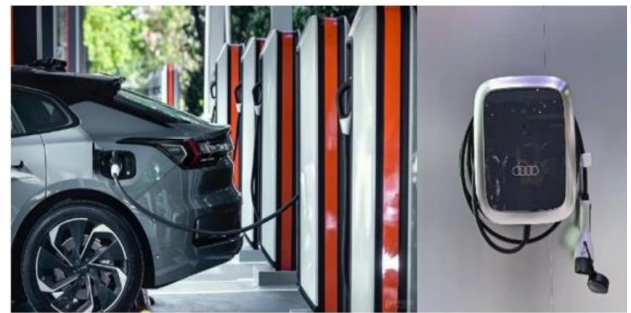
图 19：充电桩（枪）线缆应用场景
