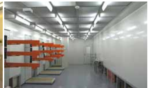
100 级 IC 电子洁净室
