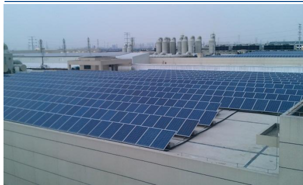
图 2：中利 11 年建成的光伏屋顶项目（售予中电投）
