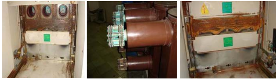
图表 33. 某电力公司运行约三年后的国产真空开关柜腐蚀情况
