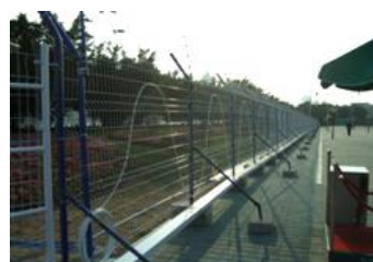
亚运开幕式主会场电子脉冲系统及震动光缆报警系统
