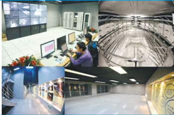
图表15: 中央控制中心实时监测管廊系统
