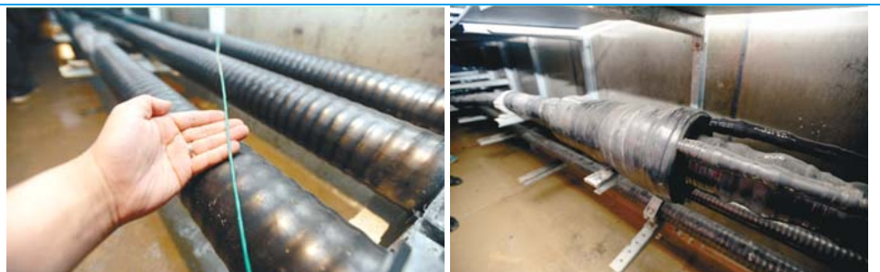
图表14: 管廊内部感温光缆与 66KV 高压线
