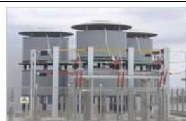
典型工程：G-SVC高压静止式动态无功补偿装置
