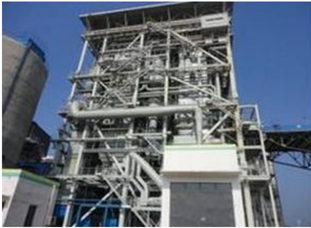
图 19: 凯迪电力二代电厂采用高温超高压循环流化床
