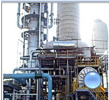
图 1：大连西太平洋石油化工硫磺回收装置
