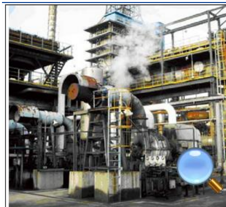
图 2：上海石化加工含硫原油改造工程 2# 炼油联合装置及配套工程(二期)4.2 万吨年硫磺回收装置
