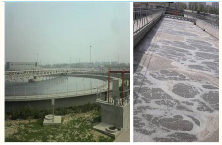
图表 36：污水处理设备：刮吸泥、曝气滤池、格栅设备
